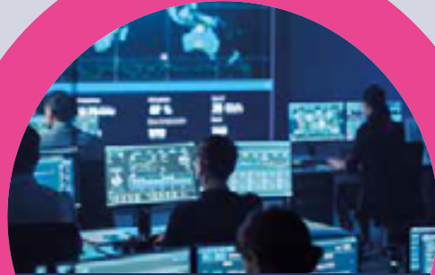
Sala de Control
